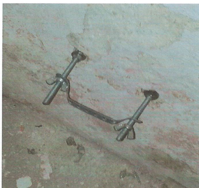
INSTALLAZIONE NON TERMINATA
